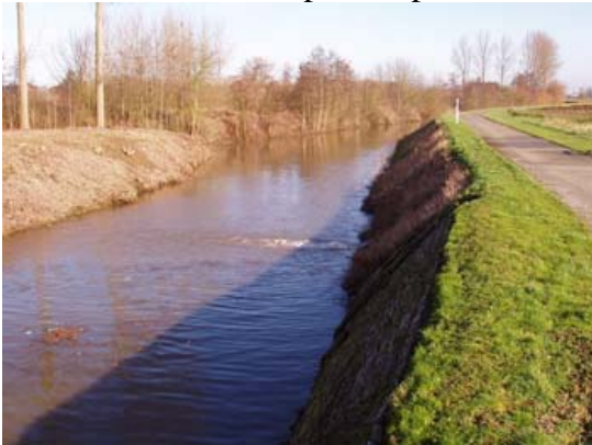
Figure 17 : Surplomb en aval de l'écluse
