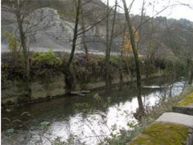
Photo 14. Carrière de Dapsens, berges bétonnées, ripisylve perchée (25/11/2005).
